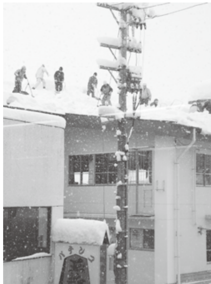
↑集落公民館の除雪。地面からの高さ約 10 m は落下すれば命の危険があります。(大割野集落)
